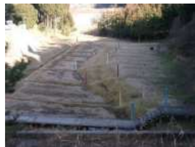
深溝断層(幸田町大字深溝字小井文字)三河地震の際にできた断層で、最大落差は約1.5m、最大左ずれ変位量が約1m。
